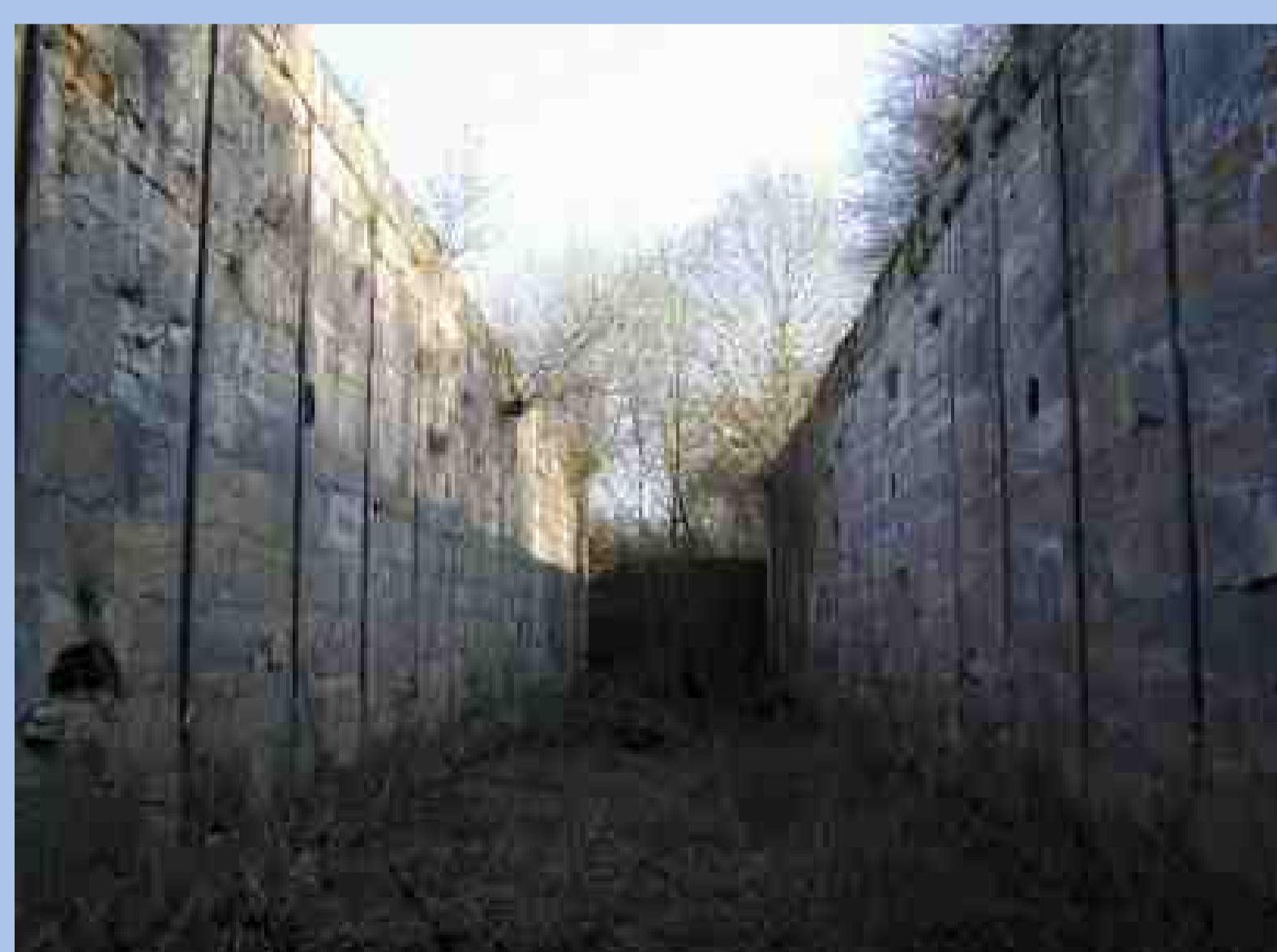
Bis zu ihrer Sanierung war die Schleuse 94 durch Wildwuchs überwuchert und nur schwer zugänglich. (Foto: Robert Schäfer)
